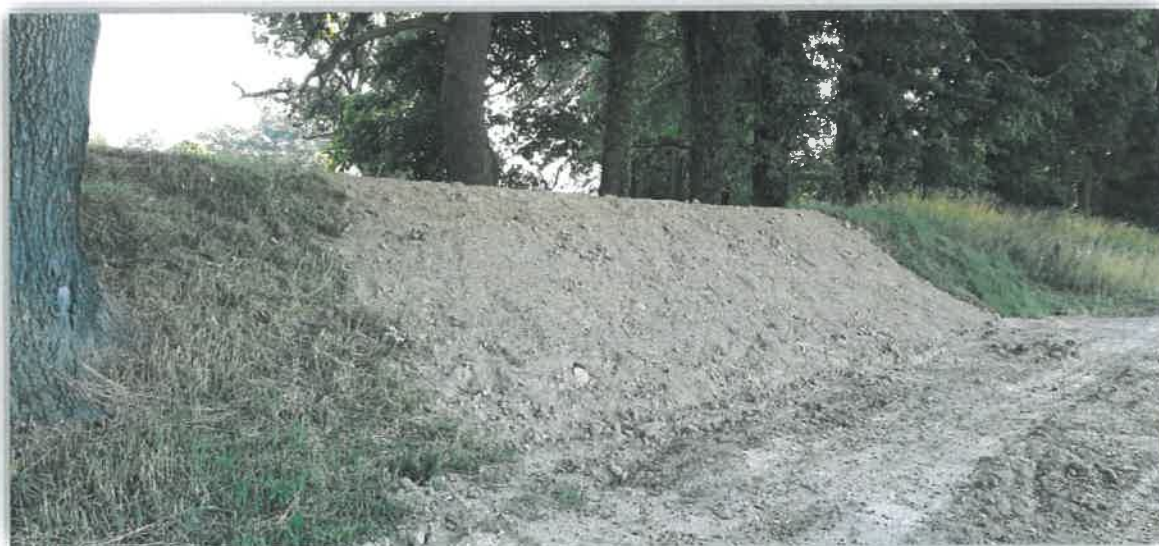
Wał przeciwpowodziowy Trzebień Mały – Parkoszów uszkodzony i po odtworzeniu
