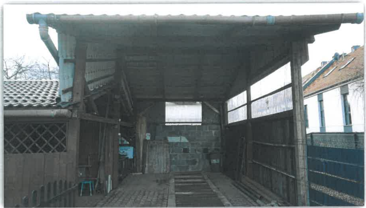
Samowola budowlana przy ul. Mostowej w Bolesławcu
