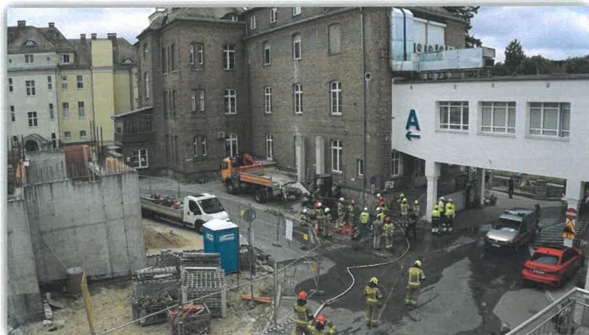
Uszkodzenie podziemnej instalacji gazowej w wyniku prowadzonych robót budowlanych na terenie Szpitala Św. Łukasza przy ul. Jeleniogórskiej w Bolesławcu
