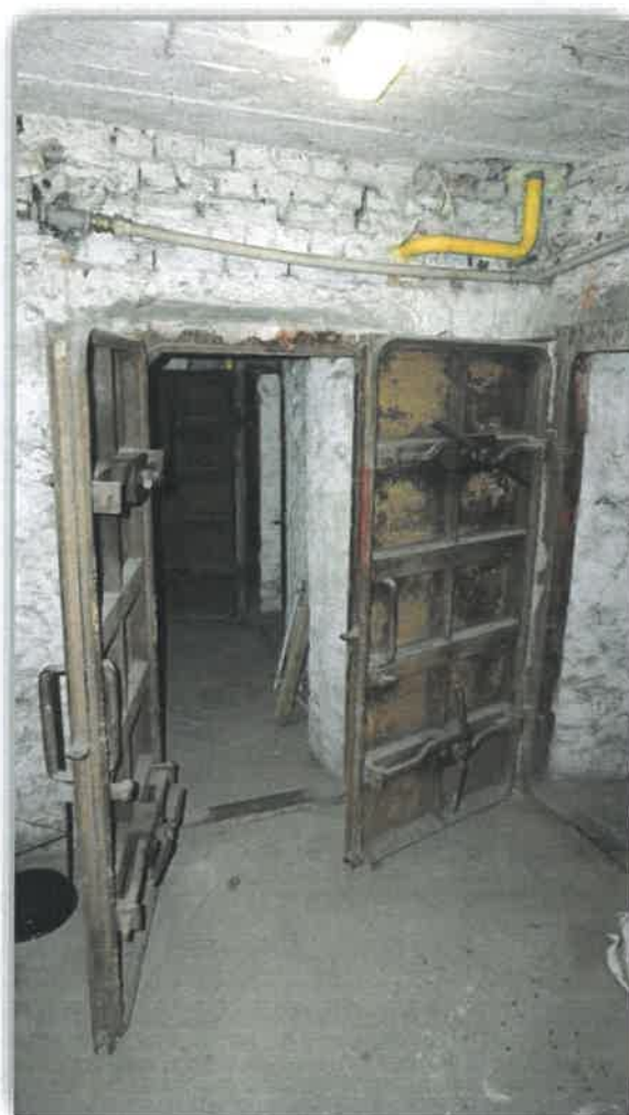
Drzwi hermetyczne do schronu w budynku przy ul. Kaszubskiej 2 w Bolesławcu
