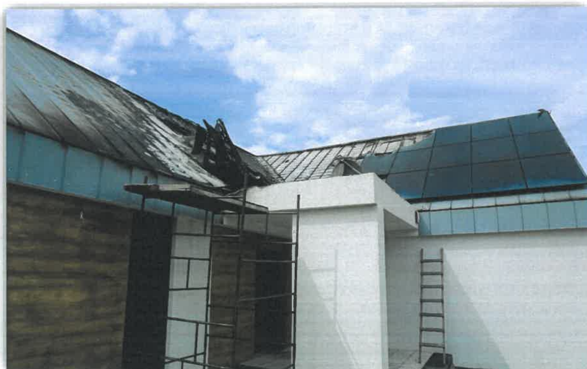
Pożar budynku mieszkalnego jednorodzinnego w Łaziskach
