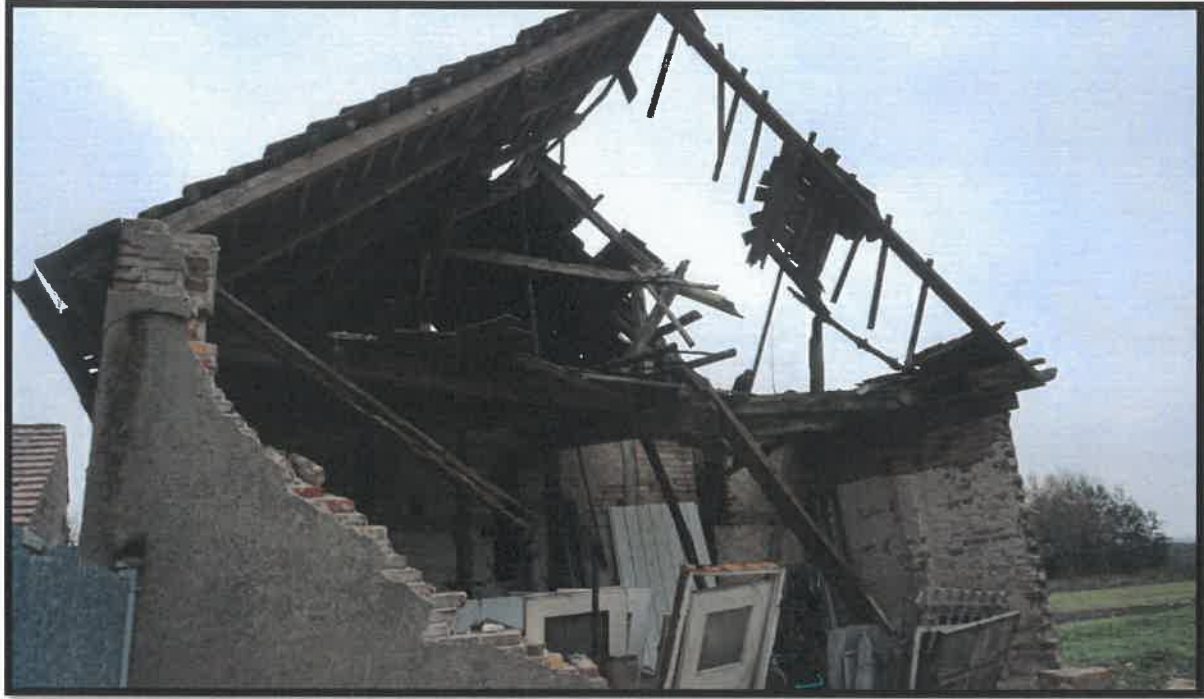
Budynek gospodarczy po zawaleniu więźby dachowej i ścian zewnętrznych -Kraśnik Dolny. Rozebrany po decyzji nakazowej PINB.
