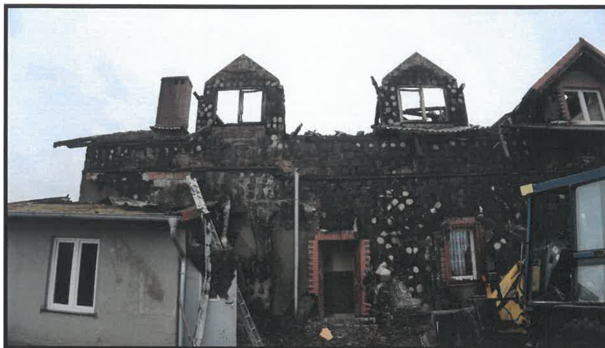
Budynek usługowy po pożarze -Nowogrodziec. Wyłączony z użytkowania po decyzji nakazowej PINB.
