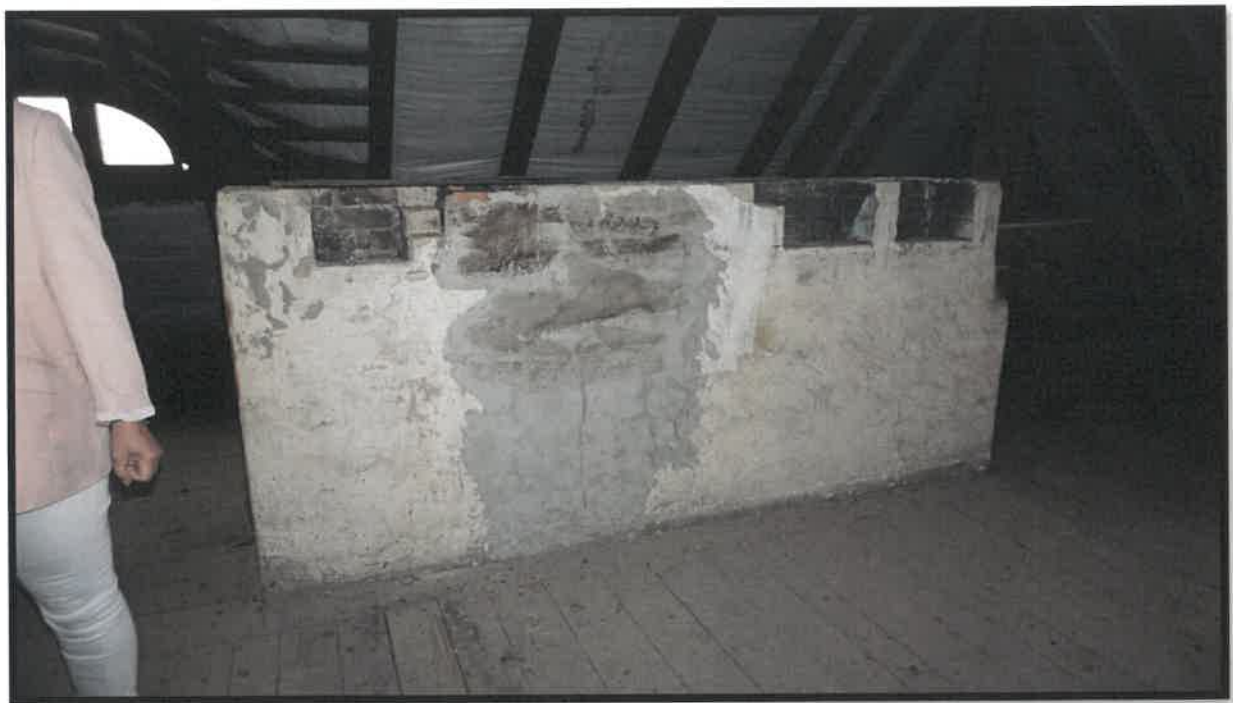
Budynek przy ul. Tysiąclecia 32 BCE – brak wyprowadzeń kominów wentylacyjnych ponad połąć dachu.
