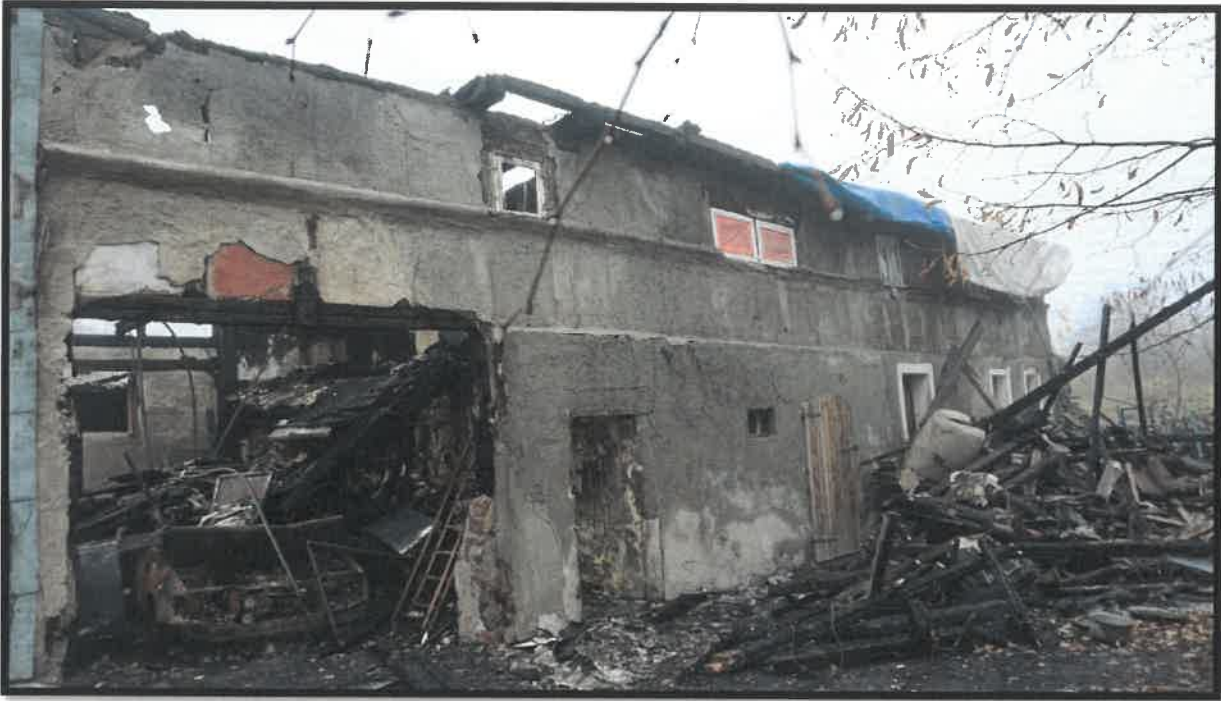
Budynek mieszkalny po pożarze -Kruszyn. Wyłączony z użytkowania po decyzji nakazowej PINB
