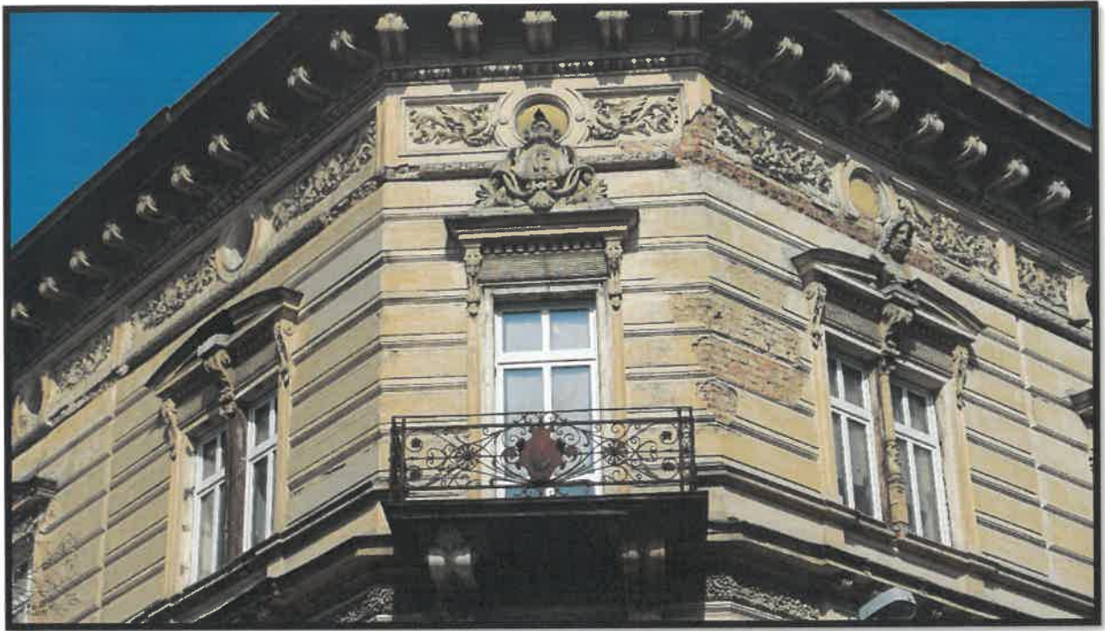
Budynek przy ul. Mickiewicza 6 w Bolesławcu – luźne elementy tynku, odpadające od elewacji, stanowiące zagrożenie dla przechodniów – usunięte po decyzji nakazowej PINB
