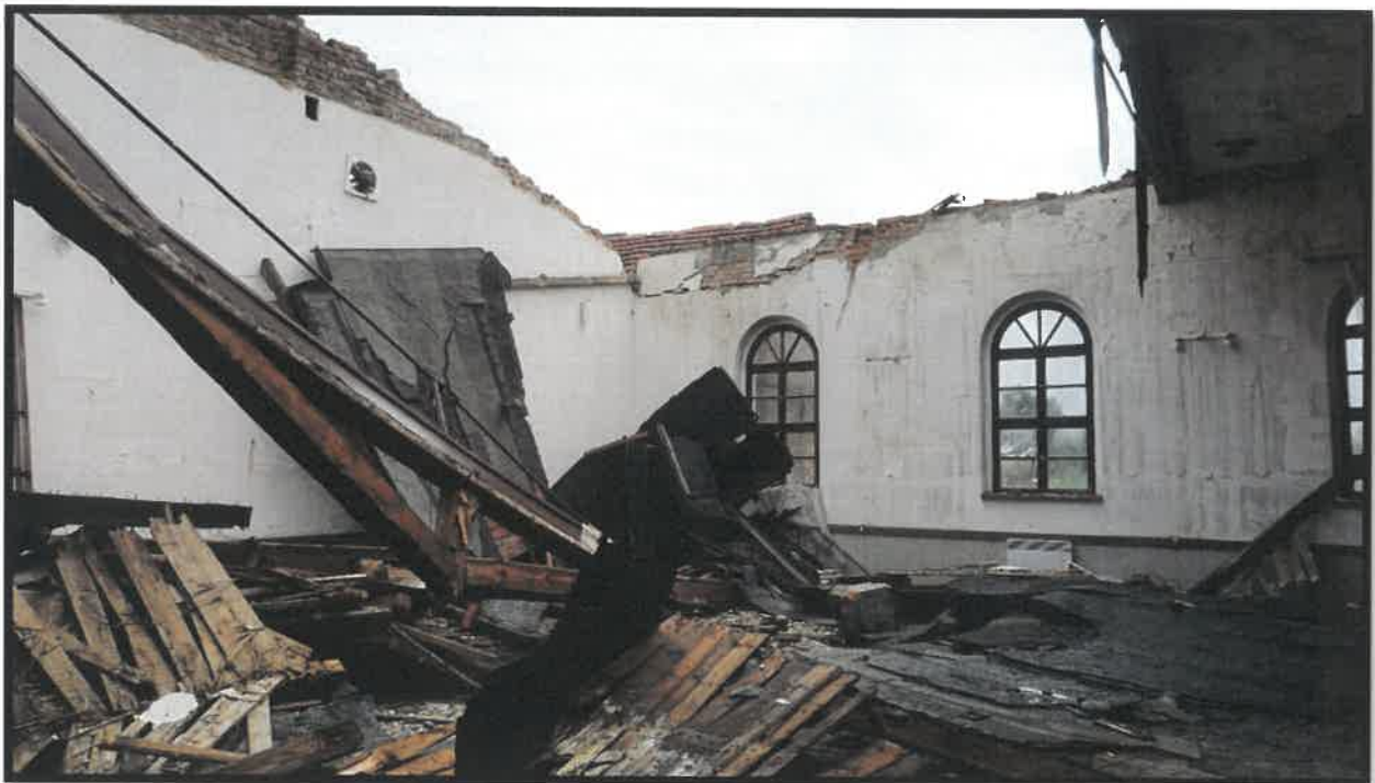
Budynek świetlicy po zawaleniu więźby dachowej – Nowa Wieś. Rozebrany po decyzji nakazowej PINB
