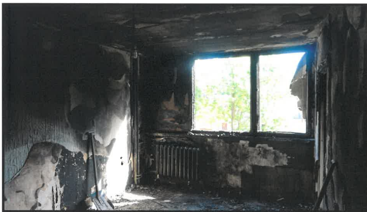
Mieszkanie po pożarze w budynku wielorodzinnym - ul. Bielska – Bolesławiec. Wyłączone z użytkowania po decyzji PINB.
