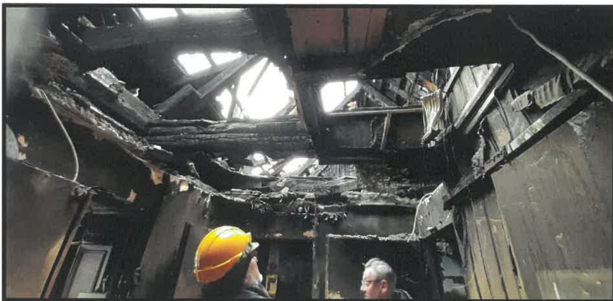
Mieszkanie w budynku wielorodzinnym po pożarze – ul. Żwirki i Wigury - Bolesławiec
