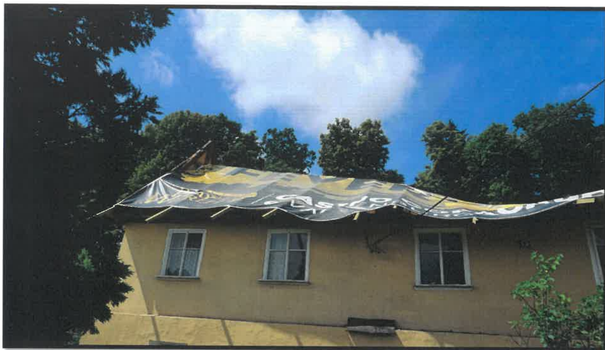
Zawalenie dachu na budynku mieszkalnym w Jurkowie. Budynek rozebrany po decyzji nakazowej PINB.
